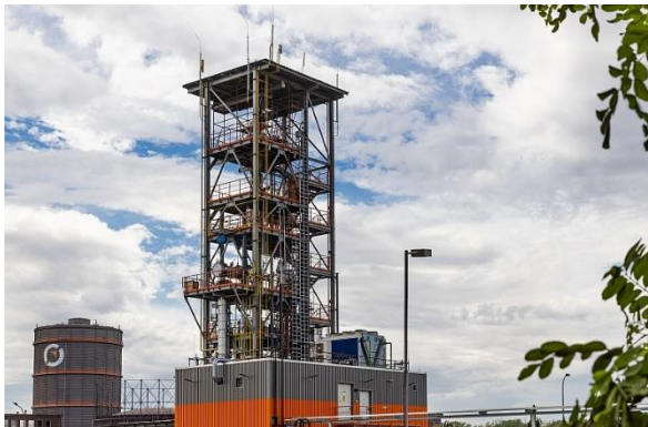
Abb. 2 µDRAL-Anlage – erste flexibel mit Wasserstoff und Erdgas betriebene Direktreduktionsanlage in einem integrierten Hüttenwerk
